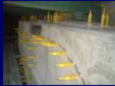
ひび割れ注入工
