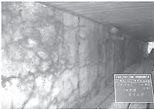
写真-1 陶橋一施工前のASR劣化状況
