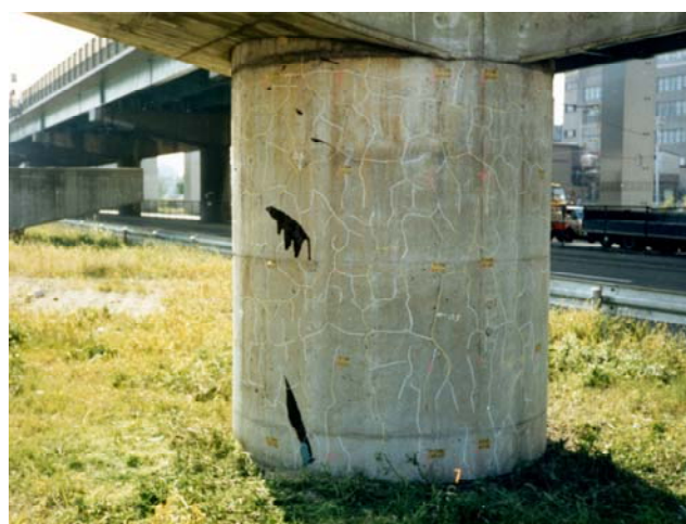
図 1.1-6 劣化事例③(橋脚)
