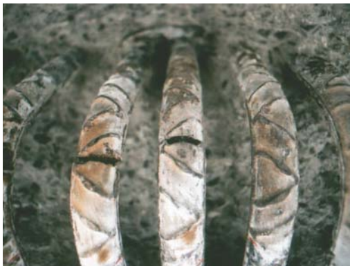
図 1.3-3 鉄筋が破断した例
