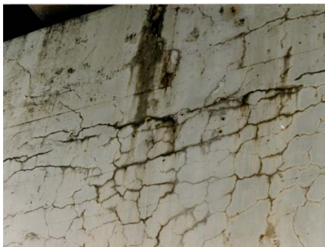
図1.1-4 劣化事例①(アバット)
