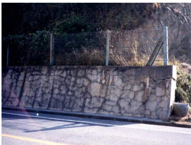
図 1.1-5 劣化事例②(擁壁)
