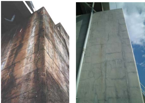
図 1.3-1 補修後劣化事例
