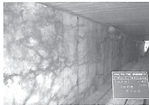
写真-1 陶橋—施工前のASR劣化状況
